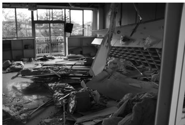
▲被災した第二さくら体育幼稚園の内部
