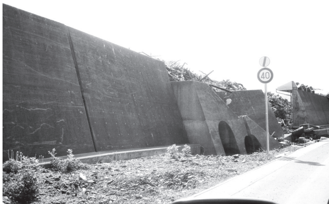
▲大きな堤防も破壊された
